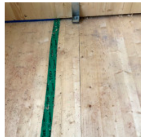
Figur 4: Tejp på bjälklagsskarv.
