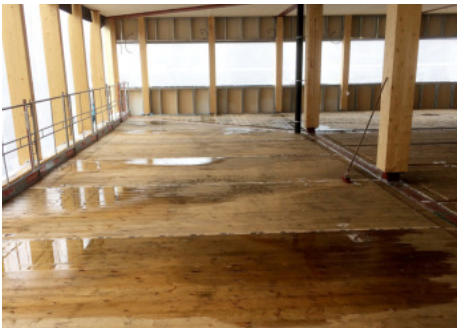
Figur 5: Flera vattensamlingar på bjälklaget i objektet i Västsverige. Det uppkom av nederbörd som runnit nedåt från framförallt ovanföriggande bjälklag.
