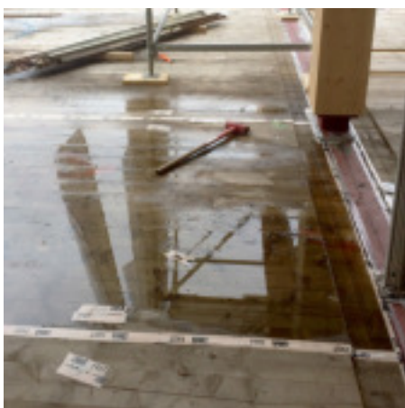
Figur 6: Vattensamling på bjälklag i objektet i Västsverige. Det uppkom av nederbörd som runnit nedåt från ovanföriggande bjälklag.
