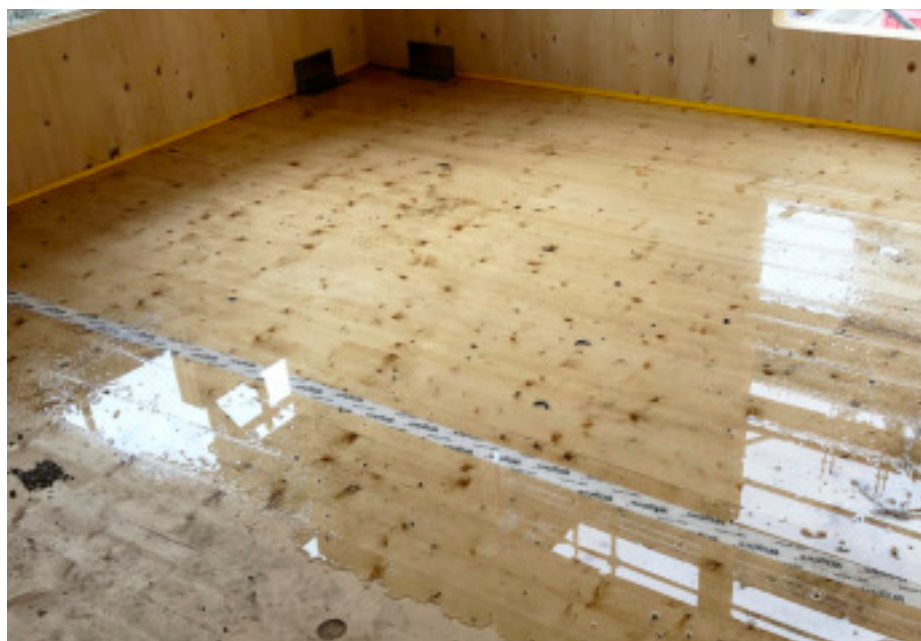
Figur 7: Vattensamling på bjälklaget i Mellansverige. Det uppkom av nederbörd som runnit nedåt från ovanföriggande bjälklag.
